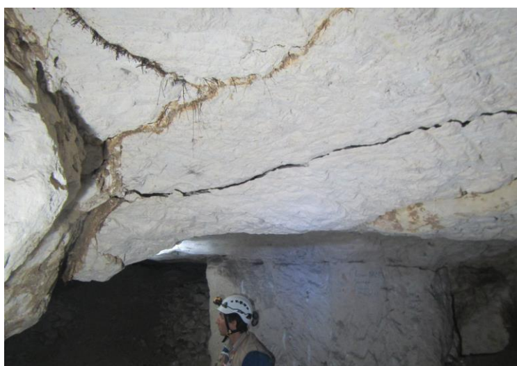
Illustration 11 : Grosse écaille isolée au toit (ici instabilité E11). A ce stade, cette instabilité n'est pas susceptible d'engendrer des désordres en surface, mais elle présente un danger pour les intervenants en souterrain
