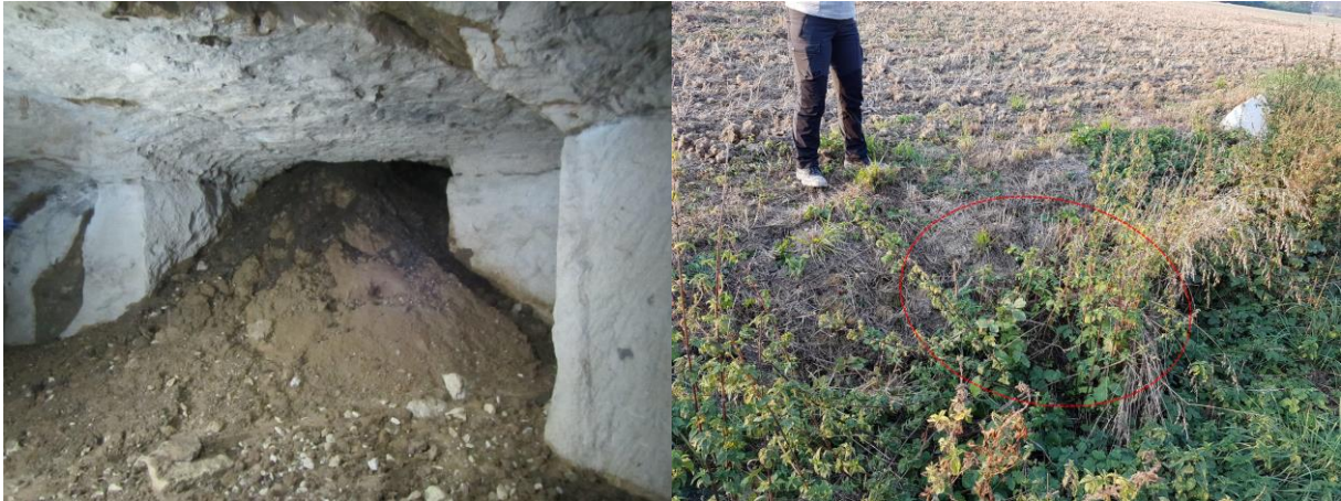
Illustration 8 : Vue sur l'instabilité D34 à l'origine d'un effondrement localisé en surface (à gauche, cône d'éboulis en souterrain ; à droite, cratère d'effondrement en partie remblayé (ellipse rouge))
