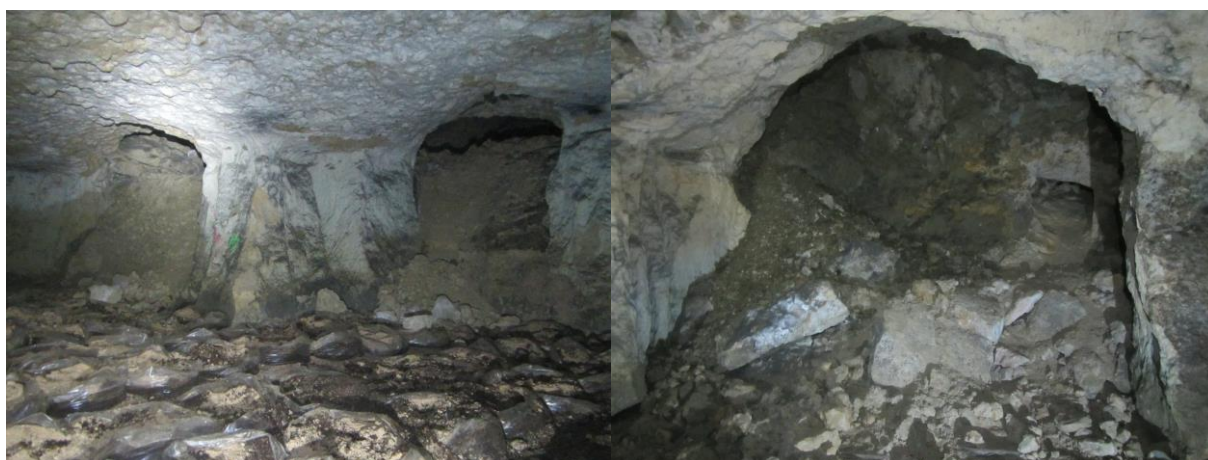
Illustration 14 : A gauche, vue sur les limites du cône d'éboulis associé à la grande instabilité D59 et à droite, éboulis associés à l'instabilité D91
