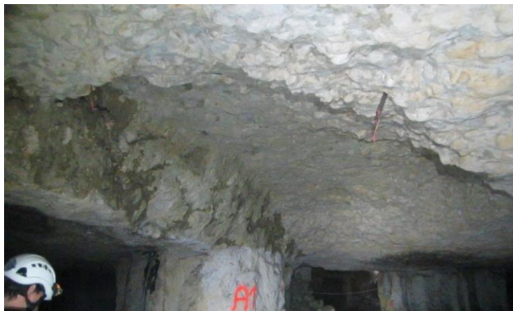
Illustration 20 : Exemple d'une chute de 1 er banc de toit délimitée par une diaclase naturelle argilisée (instabilité D43)
