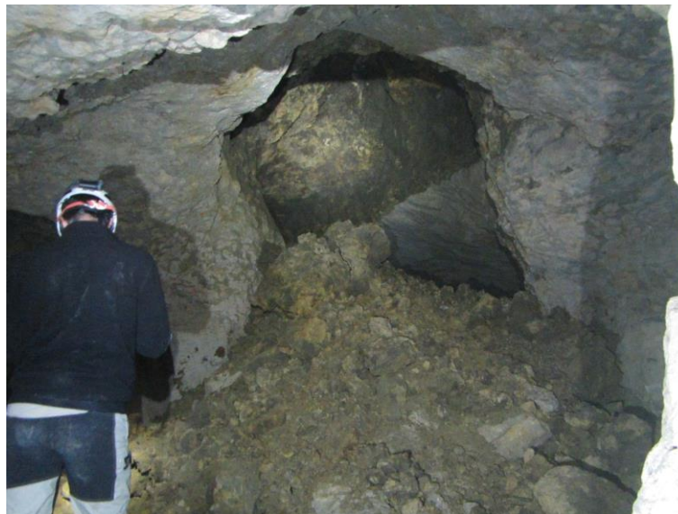
Illustration 17 : Exemple d'une cloche de fontis liée au débouffage d'un conduit karstique vertical (ici instabilité D61)
