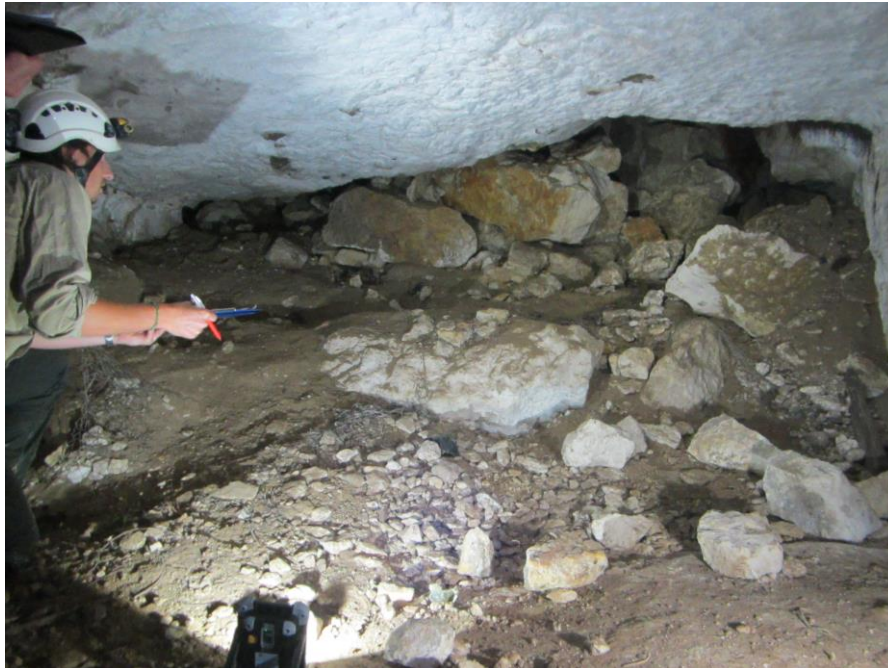
Illustration 12 : Chute de toit (D3) au sud-ouest de la carrière de Courgeon (le cône d'éboulis limite la progression vers l'ouest)
