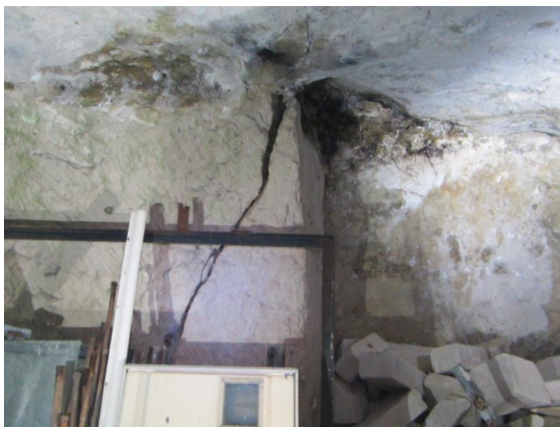
Illustration 11 : Ecaille métrique visible sur un parement, associée à la présence d'un conduit karstique
