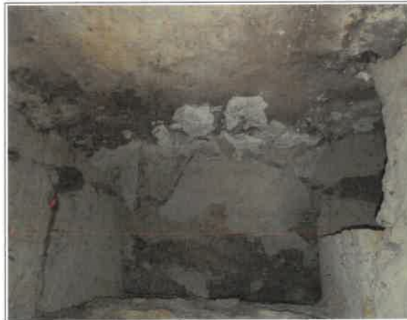
Figure III.6: chutes de toit sous la propriété Joblet (événement 6)
