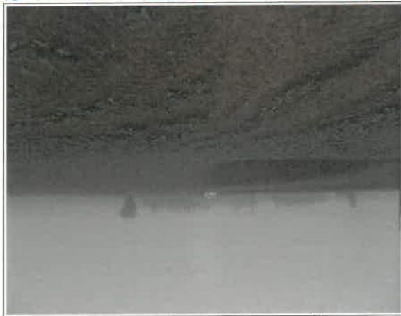
Figure III.46: forte dépression de terrain au niveau du Chemin de Curiers où sont également signalés des fontis.
