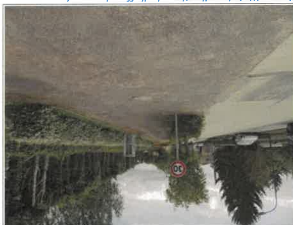
Figure III.4: localisation de l'effondrement survenu en bordure de la RD10 (événement 1).
