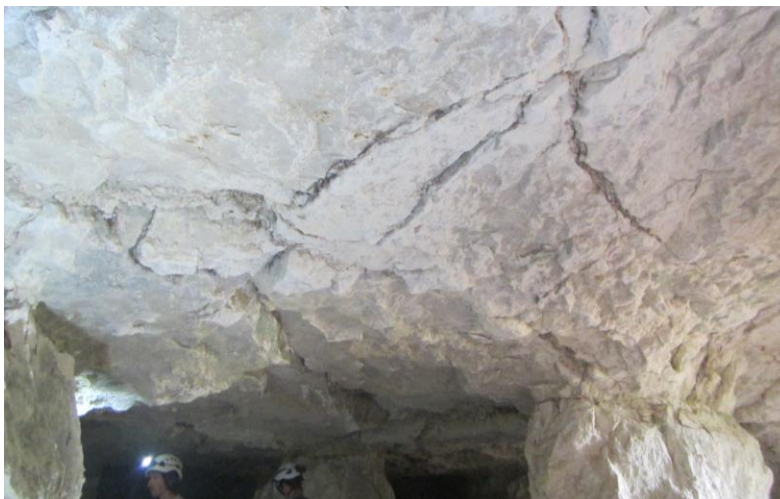
Illustration 9 : Zone d'instabilités « diffuses » à l'entrée de la carrière, associée à la dense fracturation naturelle et mécanique du toit
