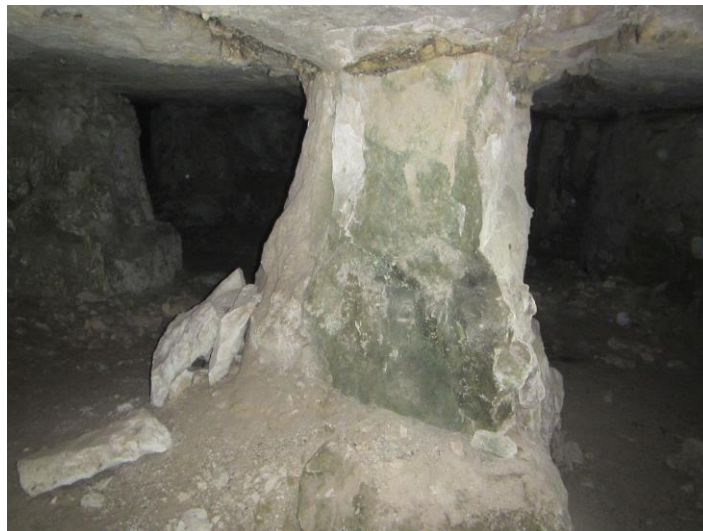
Illustration 8 : Pilier très fracturé mécaniquement, en cours d'écaillage (P13)
