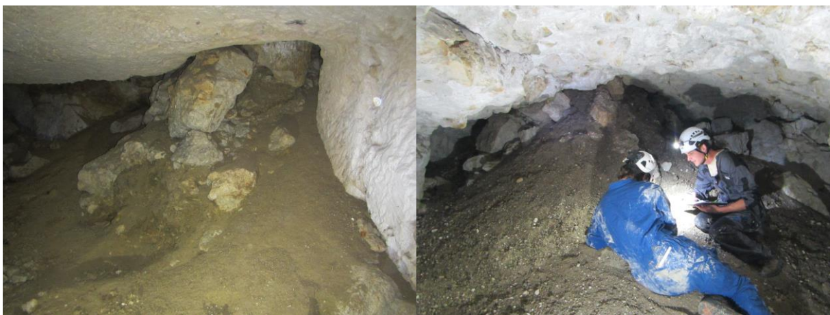
Illustration 7 : Vues sur deux cloches de fontis ayant débouurré en surface (à gauche, instabilité D7 et à droite, instabilité D28)
