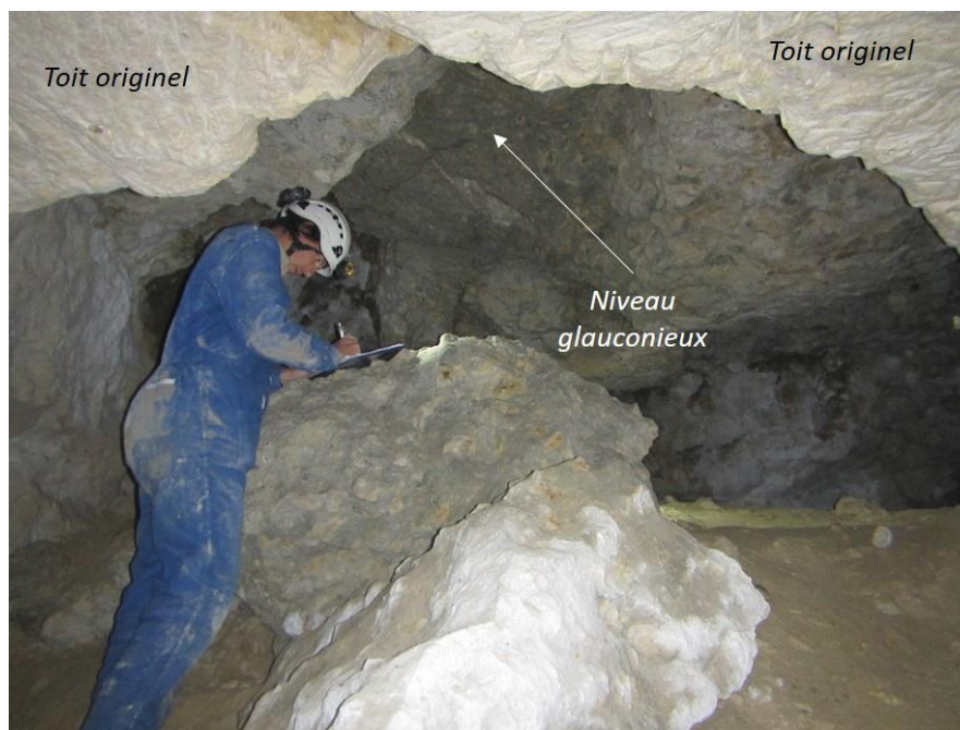
Illustration 8 : Vue sur une zone de chute de toit qui s'arrête sur le niveau glauconieux résistant supérieur
