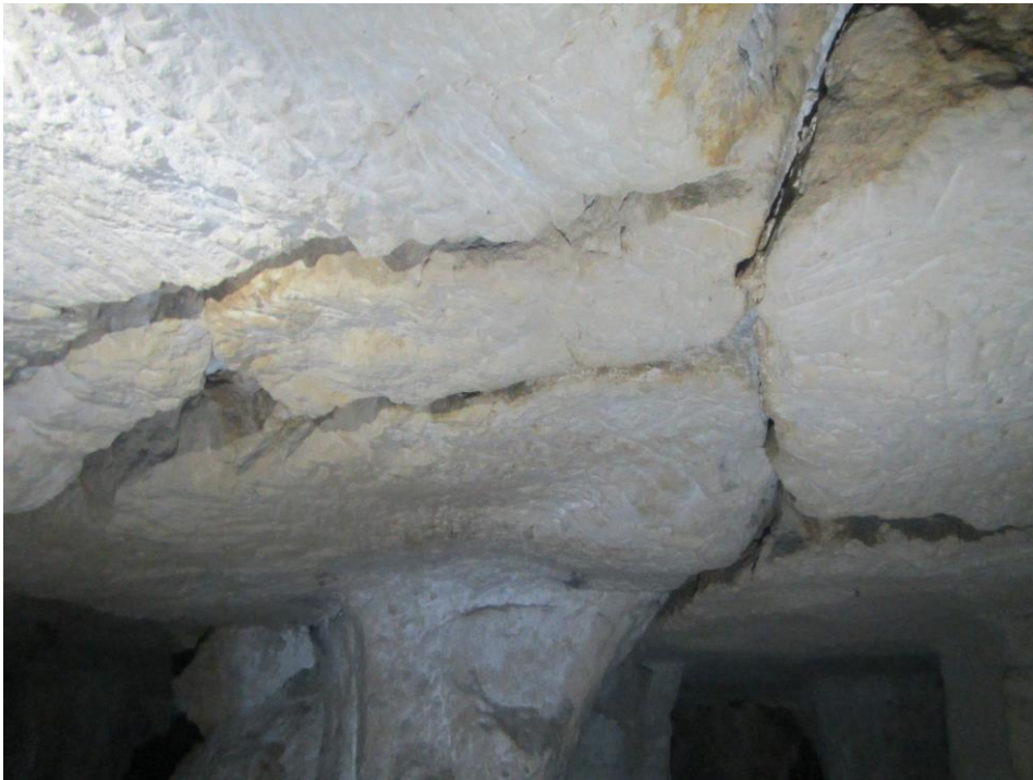
Illustration 9 : Vue sur la densité de fractures visibles au toit, à l'origine d'instabilités (ici instabilité E41)
