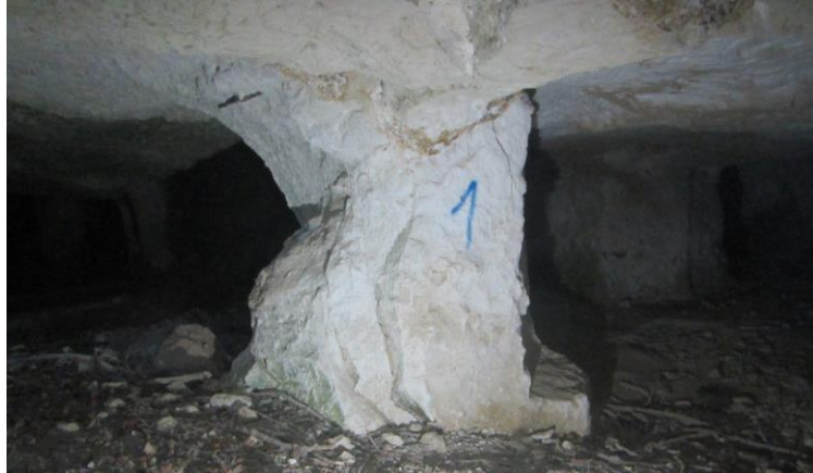
Illustration 6 : Exemple d'un pilier affecté de fractures mécaniques et traversé par une diaclase
